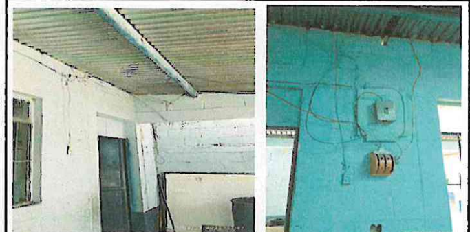
Foto 6: las aulas no cuentan con focos ahorradores, plafoneras e interruptores funcionales. Así también los tomas corrientes ya no funcionan adecuadamente y los flipones presentan problemas.
