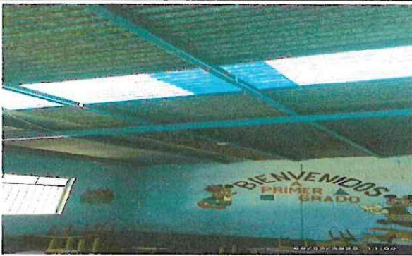
Foto 1: la cubierta de lamina del aula A y B presenta orificios los cuales al momento de llover, se filtra el agua.
