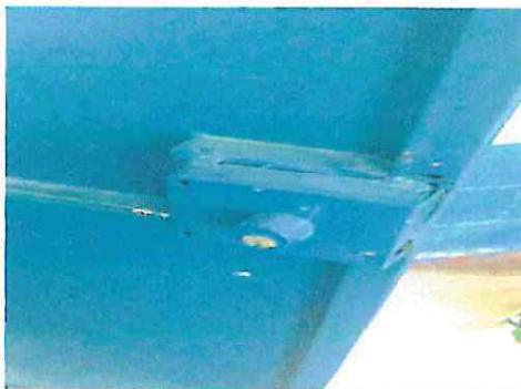
Foto 3: las chapas de las puertas de cuatro aulas ya no funcionan adecuadamente, por lo que ya no se puede cerrar las puertas y dejar resguardados los materiales.
