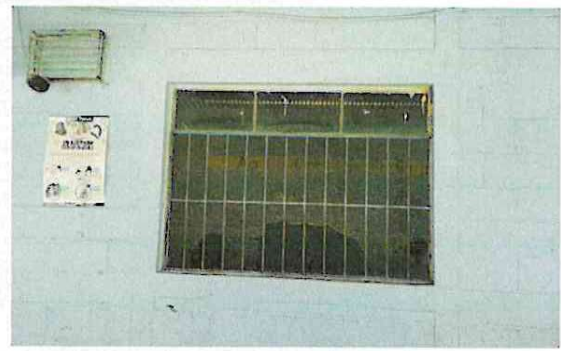
Foto 4: la estructura de metal de las ventanas presenta oxido y deterioro por el paso del tiempo sin mantenimiento.
